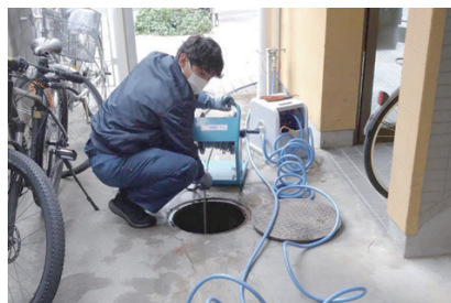
アパート共用部の排水管詰まり
