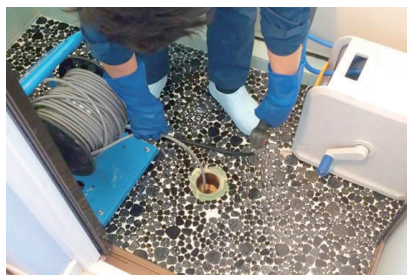
お風呂の排水管の詰まり
