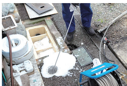
飲食店の排水管の詰まり
