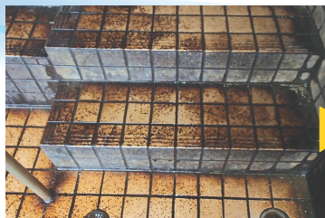
温泉浴槽タイルの汚れ
